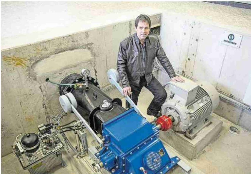
Armin Meier im Turbinenraum seines eigenen Kleinwasser-Kraftwerks in Grenchen. Bild: zvg
